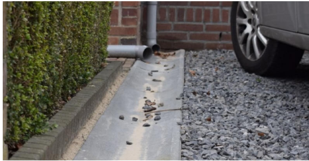
Voorbeeld afgekoppelde regenpijp met goot
